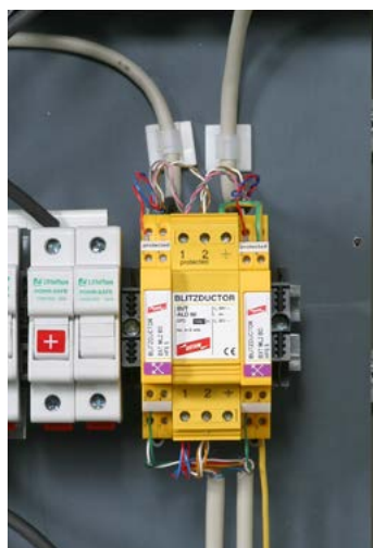
Protección de líneas comunicaciones
